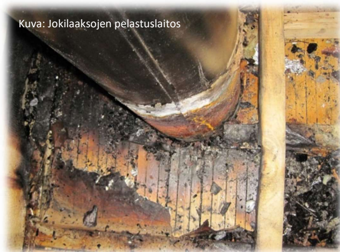
Kuva 2 Puutteellisesti toteutetun läpiviennin aiheuttama palo
